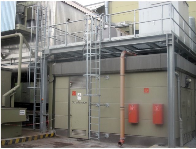
Rückenschutzbügel an Steigleiter
